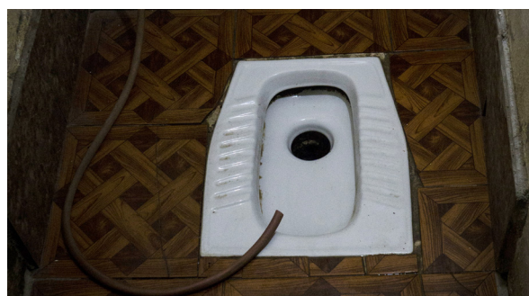
Familiens WC. Du sætter dig på hug, når du skal bruge det.
